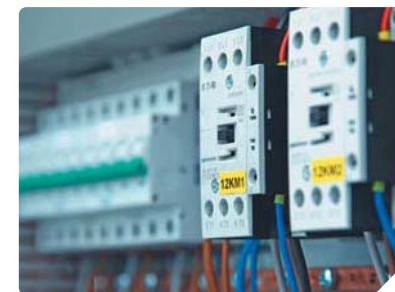
Защита компрессоров от перегрузки
