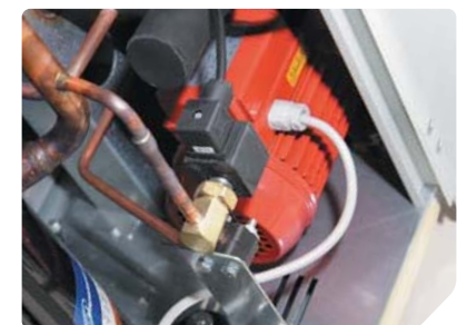
Встроенная насосная станция
