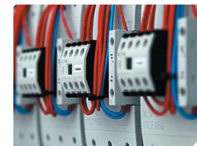
Защита компрессоров от перегрузки
